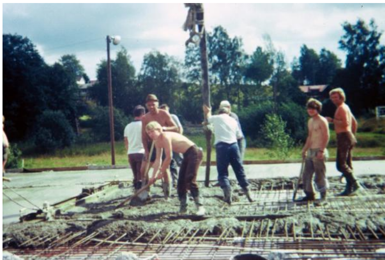
Dekke støpes. Synlige ansikter: Herbrand Fjellheim, Gunnar Støa, Jan Erik Kværnstuen og Knut Fossli
